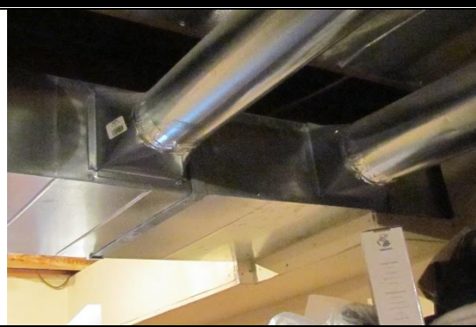
Conduits de distribution visibles dans la salle mécanique
